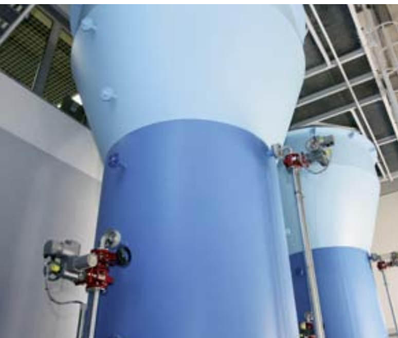
Die komplett modernisierte Entkarbonisierungsanlage im Wasserwerk Rheinau sorgt für weiches Wasser
